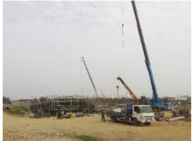
西側淨水單元-沉澱池(3/31)
