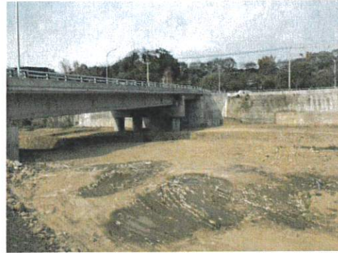
8. 已完工之聯外橋樑工程形成之裸露地 (112.03.22)
