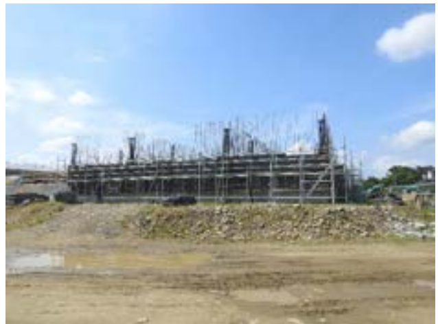
西側淨水單元-快濾池(6/26)
