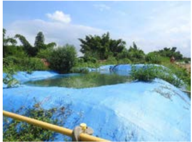
臨時滯洪沉砂池(6/26)
