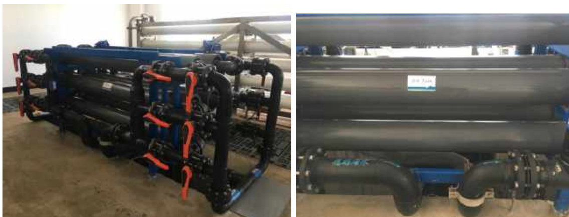
圖 4-3 袋式過濾器照片(西嶼海淡廠)
