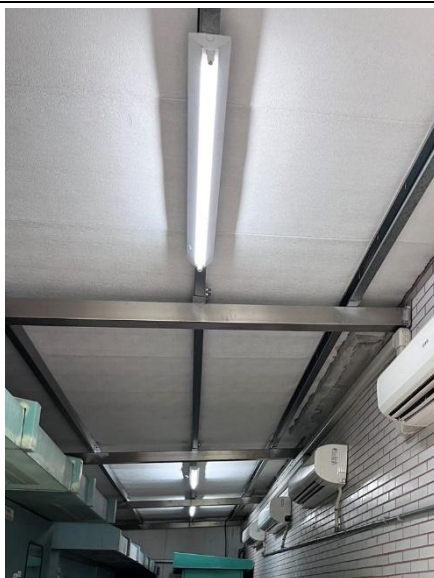
圖5 配電室1的3盞照明設備
