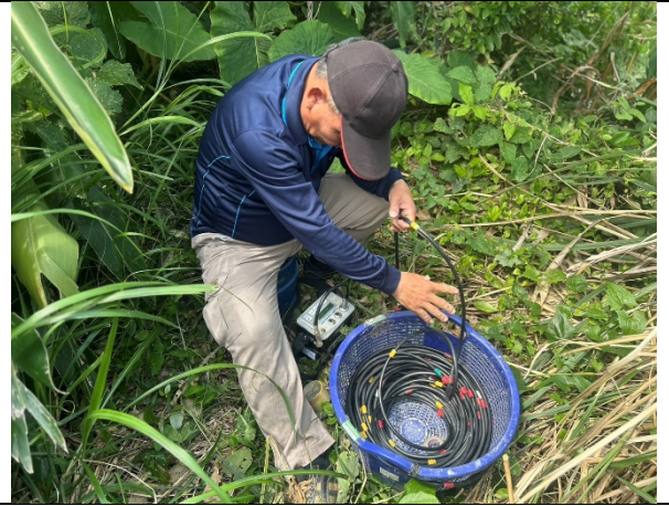
傾斜管觀測-量測(115.05.26 地震後)
