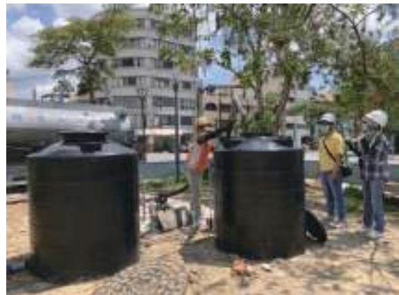
圖2-2-25 台中葫蘆墩公園地下水井儲藥槽 添補次氯酸鈉
