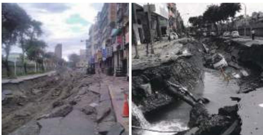
圖2-2-12 凱旋三路 \phi 400mm送水管線損壞照片
