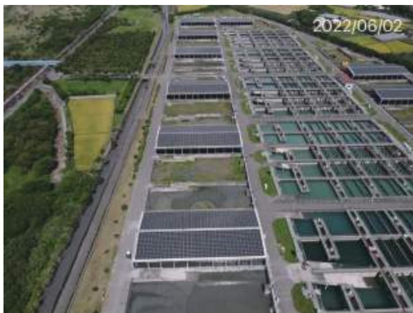
圖2-10-10 湖山前處理場之光電發電設備設置現況
