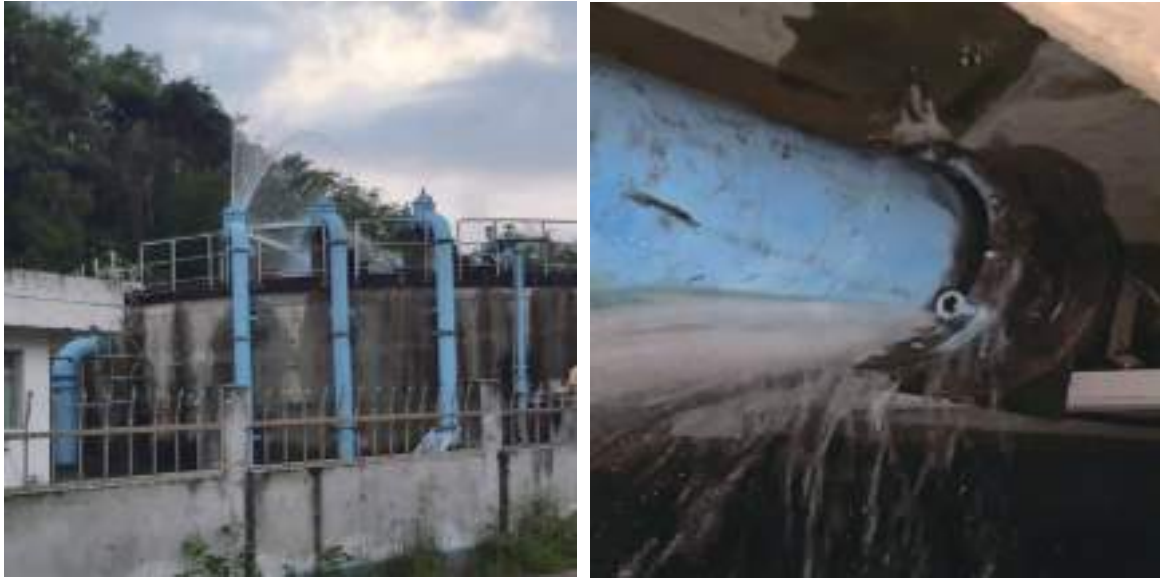
圖2-2-37 寶華橋破管與遭地震毀損管線
