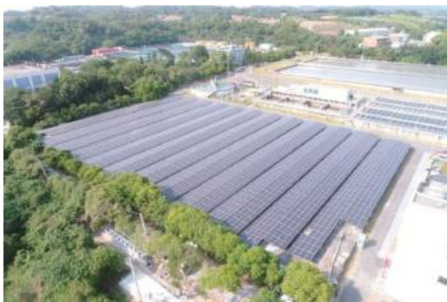
圖2-10-9 深水配水站之光電發電設備設置現況
