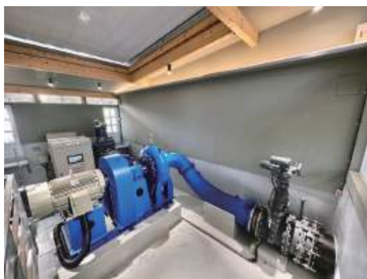
圖2-10-12 利嘉淨水場小水力發電電廠-內部發電設備
