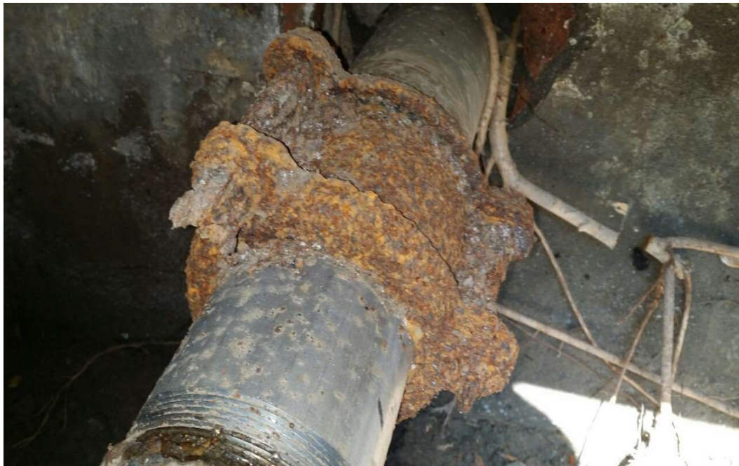
圖(15)管線腐蝕漏水，總表前管線會請工務股協助修復，用戶內線則請用戶修復管線後換表。
