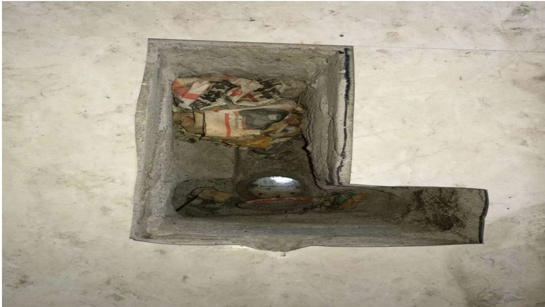
圖(7)水表磁磚下超過 30 公分，這戶水表位於增建的店面內表位過深且泥封，與用戶多次協調後表位遷移至騎樓。
