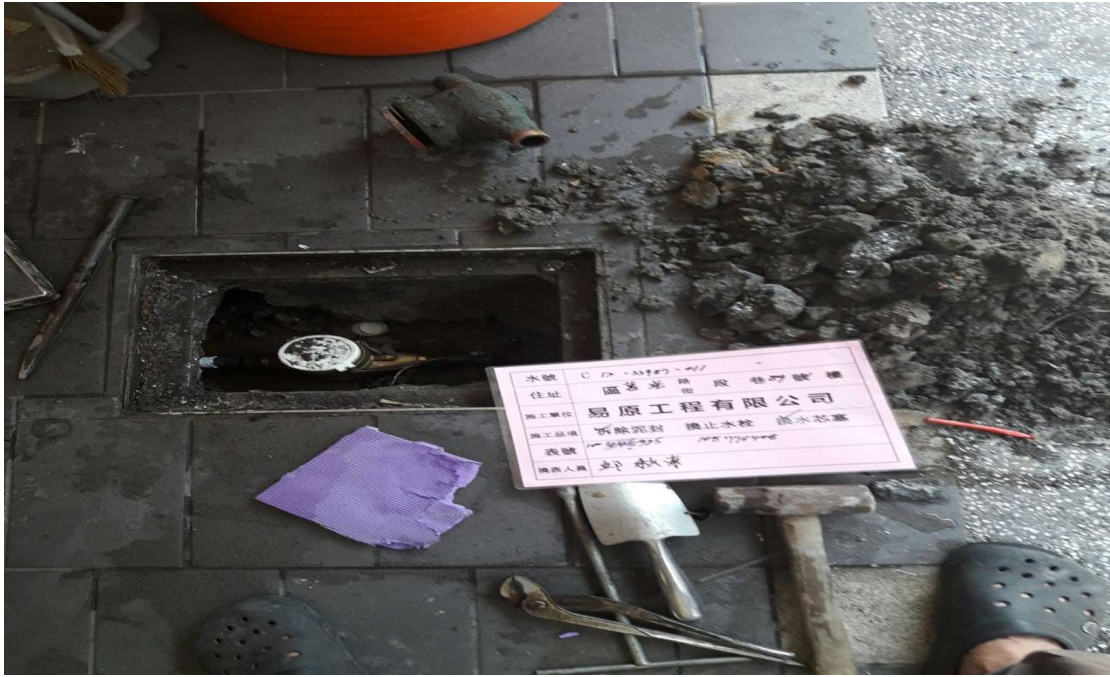
圖(12)騎樓整建泥封，需先拆除泥封後換表。
