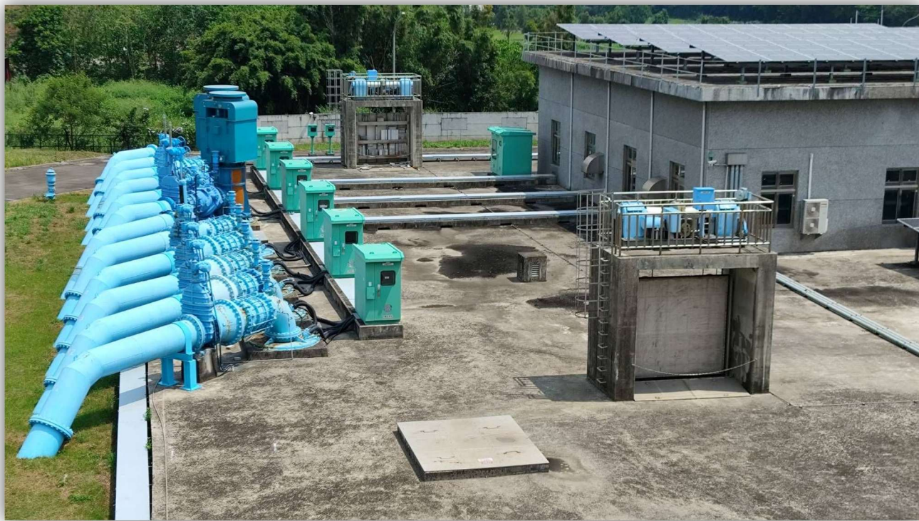
頂山腳加壓站
