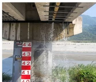
米棧大橋管線漏水
