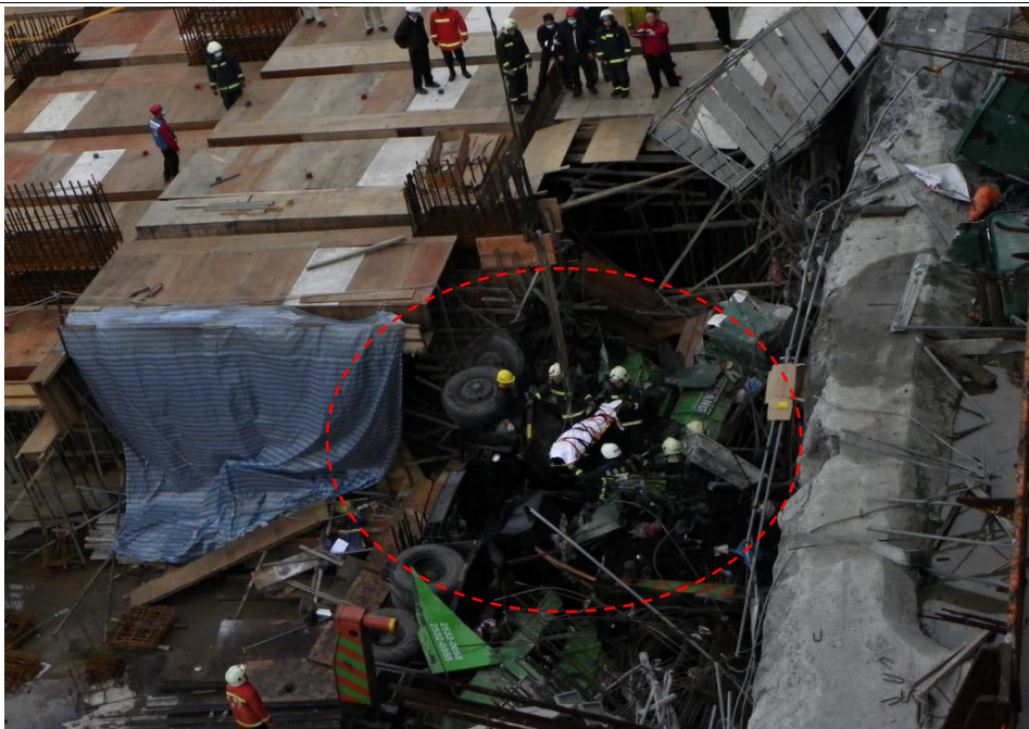
照片 2 災害發生後照片。
