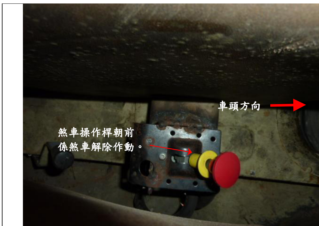
照片 8 吊起肇災之起重機，肇災之起重機駕駛座煞車操作桿呈現在解除狀態。
