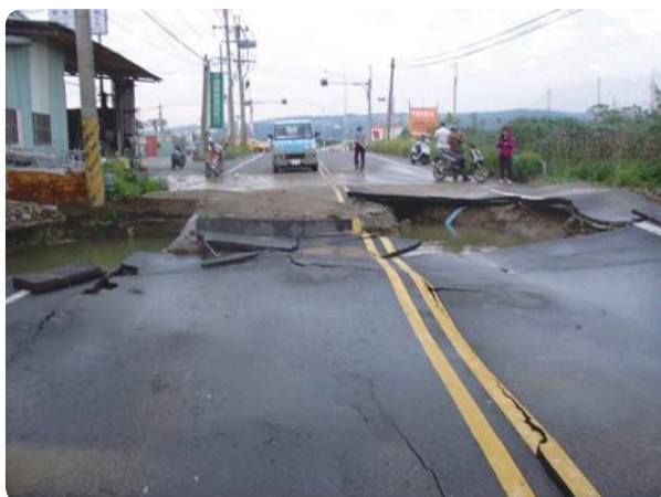
破管造成路面損壞情形
