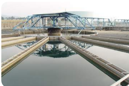
高速膠凝(污泥毯)沉澱池
