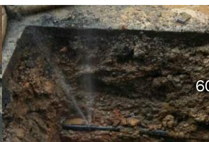
漏水點開挖及水花噴濺情形
