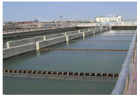
傳統式(水平流式)沉澱池
