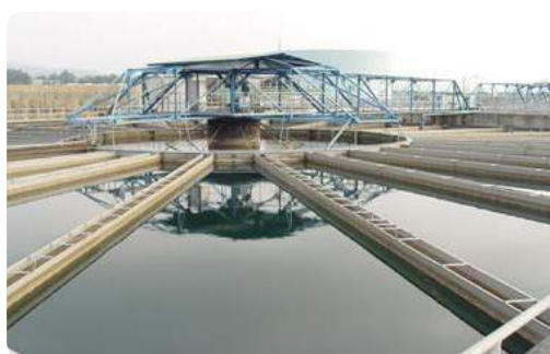
高速膠凝(污泥毯)沉澱池
