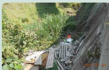
台南大內區曲溪橋(傾倒廢棄物)污染之情形
