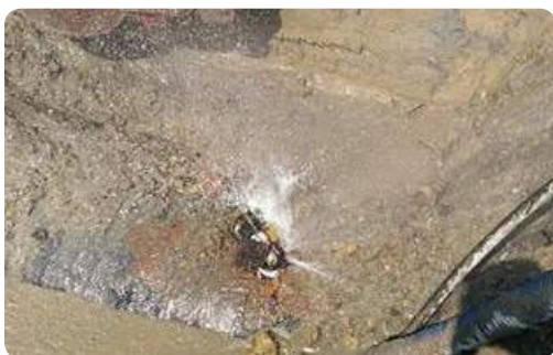
確認漏點位置及裂縫長度
