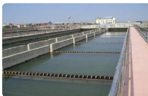
傳統式(水平流式)沉澱池
