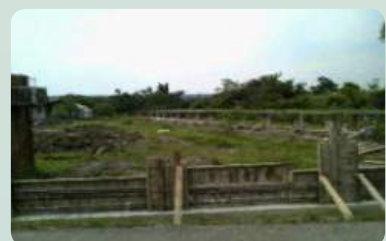
新北市市三峽區茅埔路山坡地開發污染之情形
