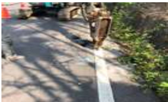
破管造成路面損壞情形
