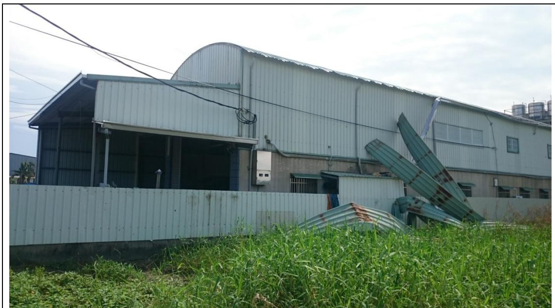
照片 1：災害發生是日進行屋頂修繕作業(更換鋼浪板)
